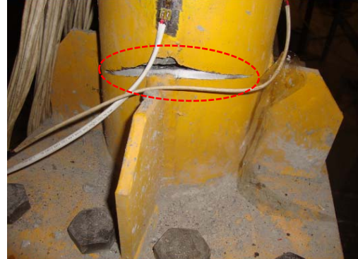
(d) Fracture near the top of stiffeners
